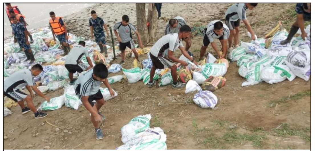
उद्धार कार्यमा नेपाली सेना : रौतहटको दुर्गाभगवती गाउँपालिका-३, मत्सरीमा बागमती नदीको कटान रोक्न स्थानीयसँगको सहकार्यमा तटबन्ध निर्माण गर्दै नेपाली सेना। तस्वीर : सौजन्य नेपाली सेना/रासस
