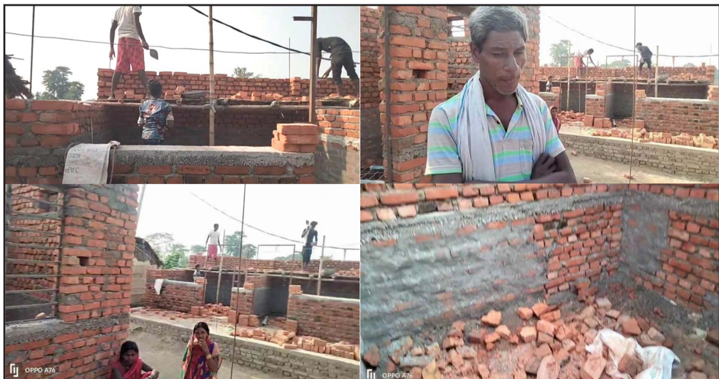
वीरगंज महानगरपालिका-२८ दरबारमा निर्माण भइरहेको जनता आवास कार्यक्रम अन्तर्गतको भवन निर्माणमा कामसल सामग्रीको प्रयोग भएको छ। उपरोक्त समितिमार्फत छजना परिवारको लागि छवटा घर बनिरहेकामा अहिले दुई नठबर ईटा प्रयोग गरिएकामा स्थानीयवासीले गुनासो गरेका छन्। तस्वीर: नितेश कर्ण
