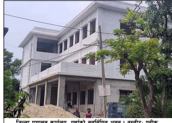
जिल्ला प्रशासन कार्यालय, पर्साको नवनिर्मित भवन । तस्वीर: प्रतीक
