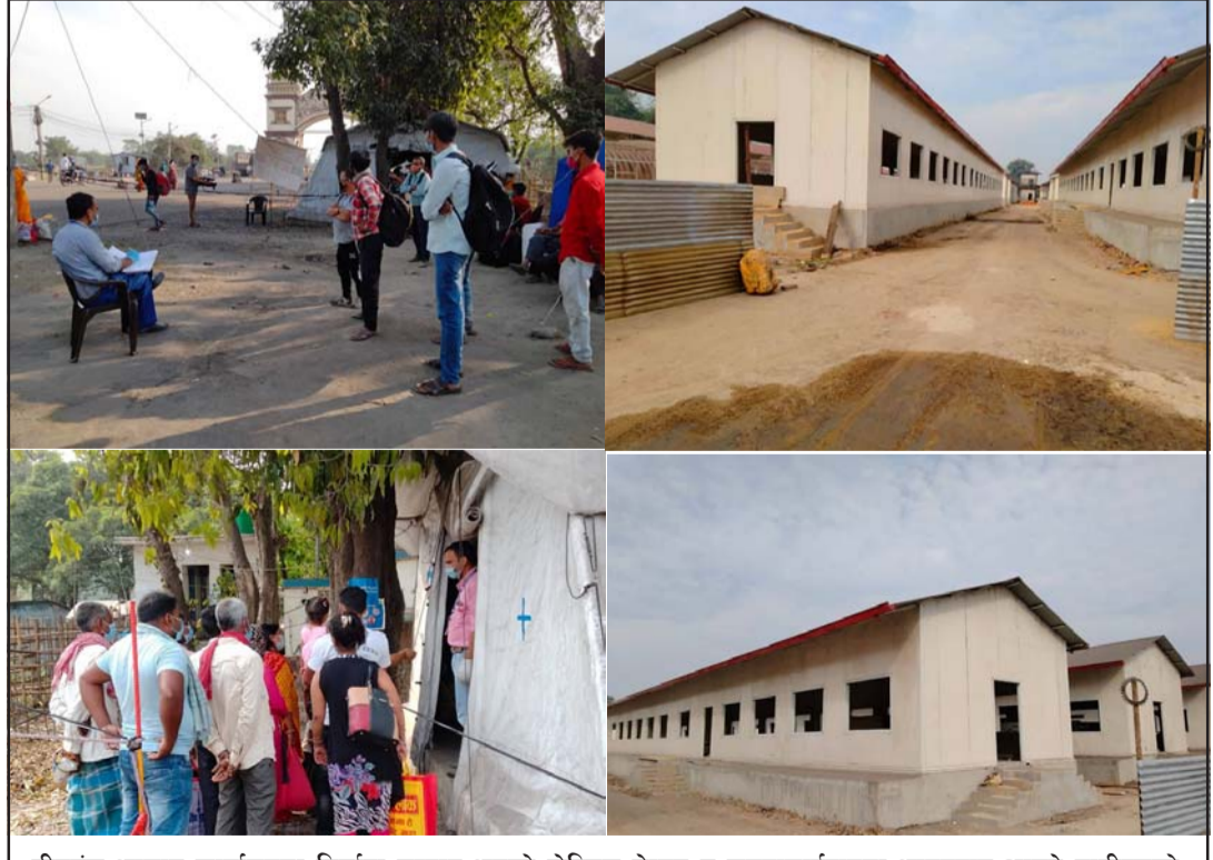
वीरगंज भन्सार कार्यालयमा निर्माण सम्पन्न भएको होल्डिङ सेन्टर र शङ्कराचार्यद्वारा भारतबाट आउने यात्रीहरूको कोरोना परीक्षण गरिँदै । तस्वीर: प्रतीक
