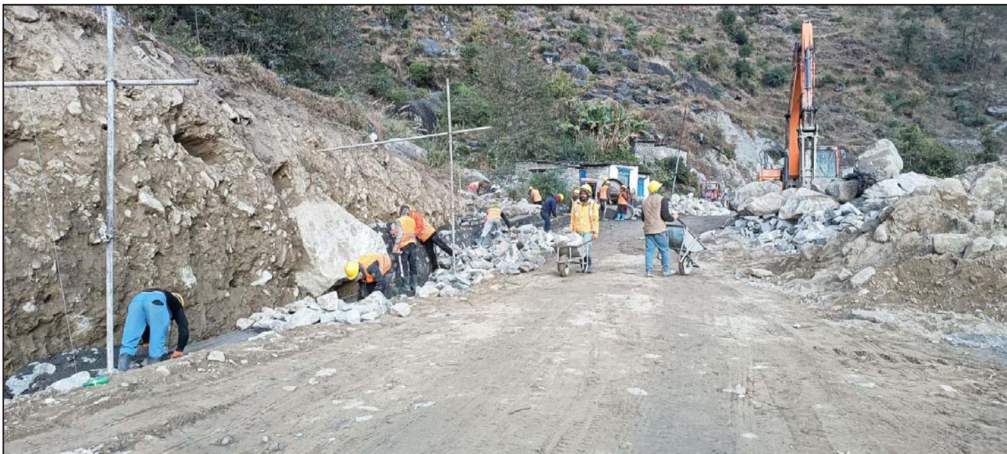
काभ्रेभरी सडक स्तरोन्नति: बेनी-जोमसोम-कोरोला सडकखण्ड अन्तर्गत काभ्रे बजारमा सडक स्तरोन्नतिको काम तीव्र गतिमा हुँदै । उक्त सडकखण्डमा नाला, ढलान र पर्खाल निर्माणसँगै कालोपत्रको काम भइरहेको छ । तस्बिर: सुशीलबाबु थकाली/रासस
