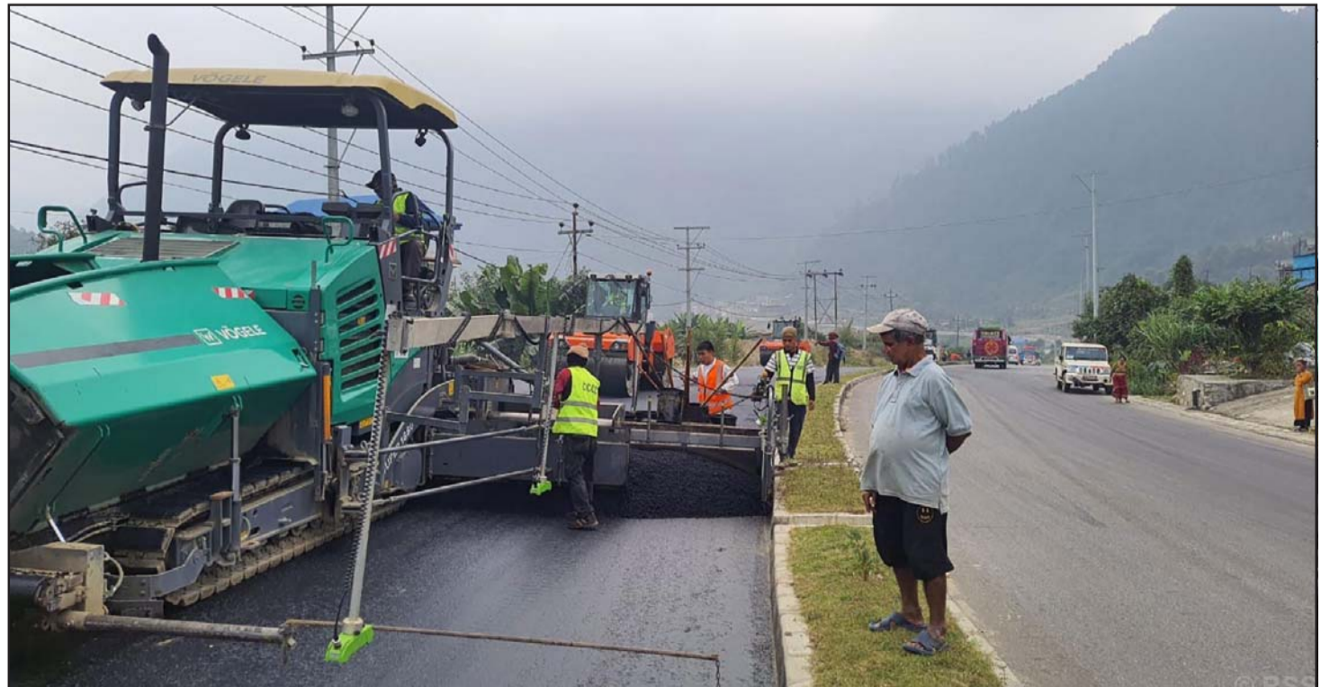
मुग्लिन पोखरा सडकमा अन्तिम कालोपत्रे: पृथ्वी राजमार्ग अन्तर्गत तनहुँको आबुखैरेनी गाउँपालिका-२ मार्काँचोक सत्र सय खण्डमा अन्तिम कालोपत्रे गरिँदै। एक हप्ताको अवधिमा २.४ किलोमिटर खण्डमा अन्तिम कालोपत्रे सकिएको छ। तस्विर: कृष्ण न्यौपाने/रासस
