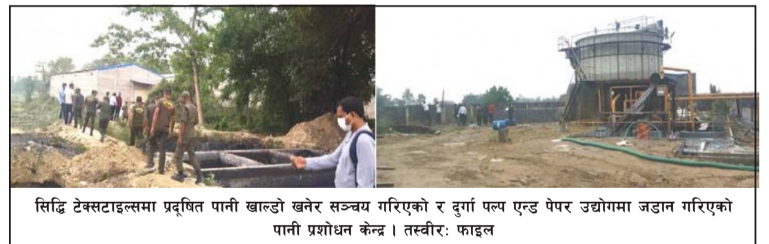
सिद्धि टेक्सटाइल्समा प्रदूषित पानी खाल्डो खनेर सञ्चय गरिएको र दुर्गा पल्प एन्ड पेपर उद्योगमा जडान गरिएको पानी प्रशोधन केन्द्र । तस्वीर: फाइल
