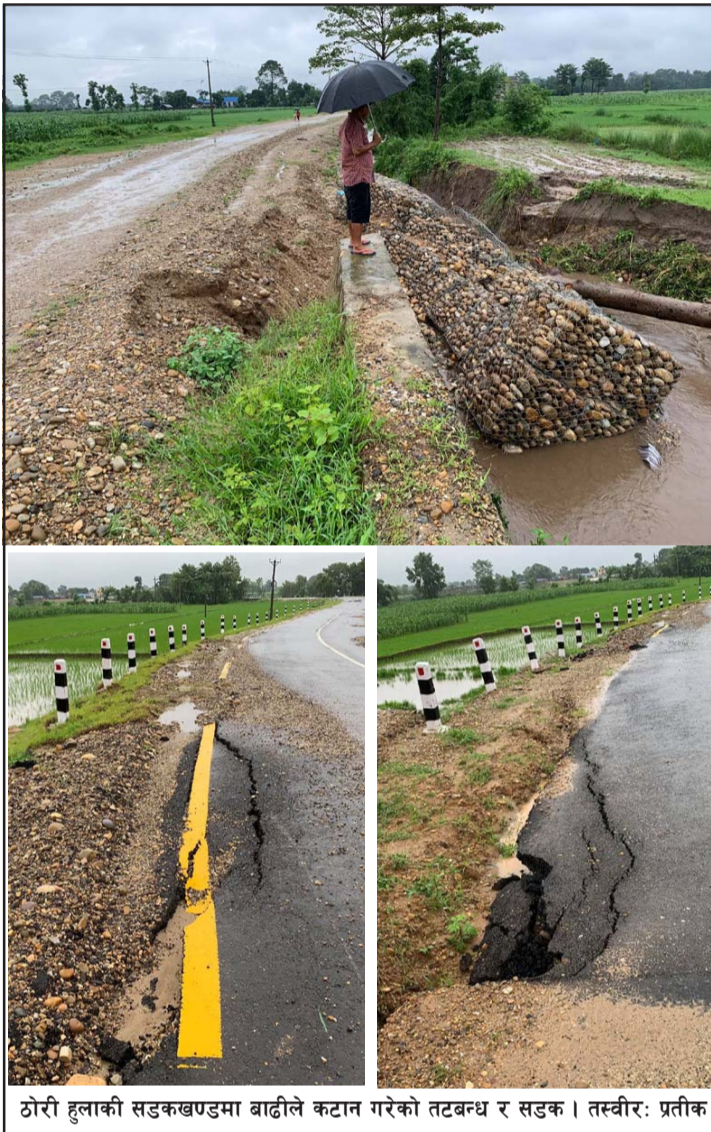
ठोरी हुलाकी सडकखण्डमा बाढीले कटान गरेको तटबन्ध र सडक। तस्वीर: प्रतीक
